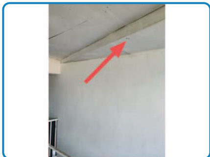
Termites de bois sec - Indices d'infestation : Altérations dans le bois, dégradations - Fèces (Vermoultures) sur Face apparente du Plafond sous pente Bois Contreplaqué
