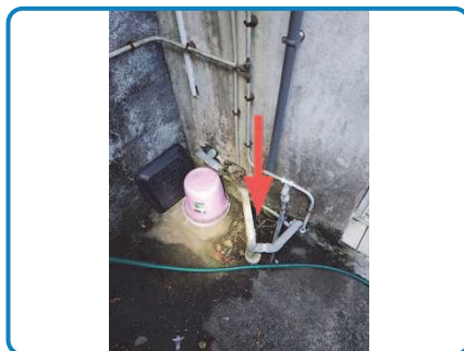
Anomalie B.8.3 e sur Install. n°4
