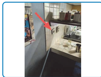
Anomalie B.7.3 a sur Install. n°5
