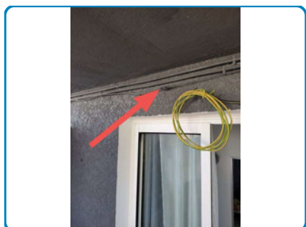
Anomalie B.7.3 d sur Install. n°1
