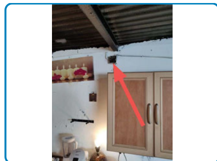
Anomalie B.7.3 d sur Install. n°1
