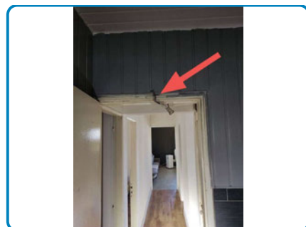
Anomalie B.8.3 e sur Install. n°1
