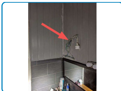
Anomalie B.8.3 e sur Install. n°1
