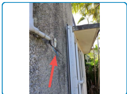
Anomalie B.7.3 c2 sur Install. n°1
