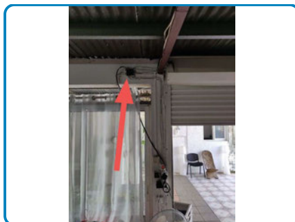
Anomalie B.7.3 d sur Install. n°1
