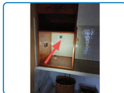
Anomalie B.7.3 c2 sur Install. n°1
